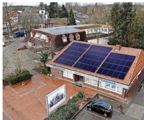
Photovoltaikanlagen auf den Filialen speisen zukünftig die Ladestationen für E-Autos.
