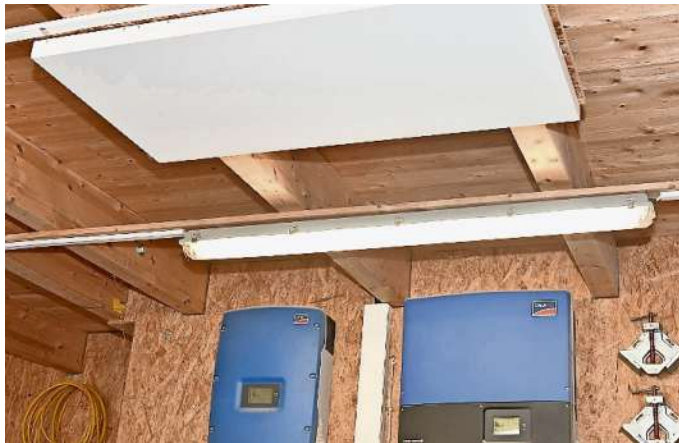
Die großen Infrarot-Heiz-Panels lassen sich direkt unter der Decke montieren.
