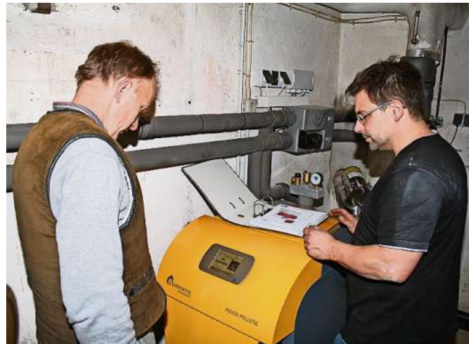
Mit einer Pellettheizung im Keller beginnt die große, energetische Veränderung im Einfamilienhaus.
