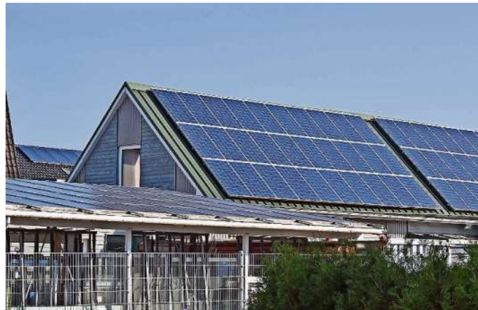
Ergänzt wird die elektrische Infrarotheizung durch zwei Photovoltaikanlagen.
