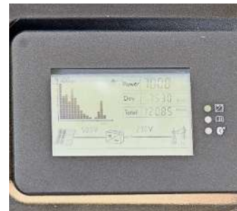
Jederzeit kann Detlef Buhrow genau ablesen, wie viel Strom seine Photovoltaikanlagen produzieren.
