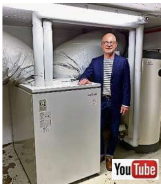
Heiko Heinen zeigt eine Luftwärmepumpe-Innenaufstellung.
